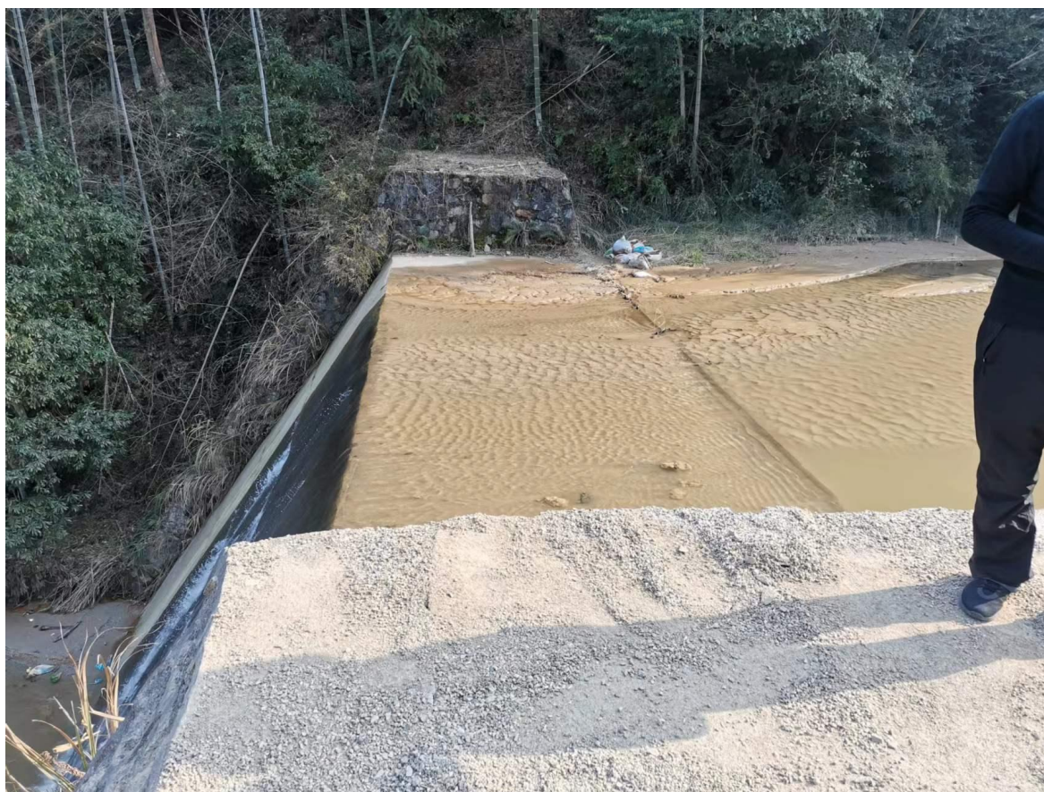
图 6 宽顶溢流堰排水现状图
